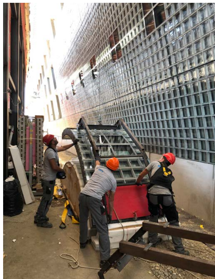
Das Einheben der Elemente wurde aufgrund der beengten Platzverhältnisse zu einer echten Herausforderung.
